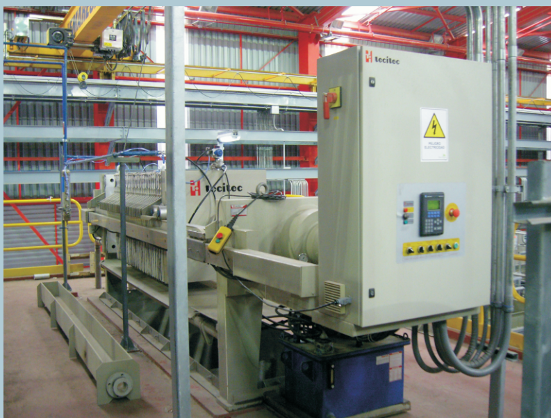
Filtro Prensa com revestimento anticorrosão
